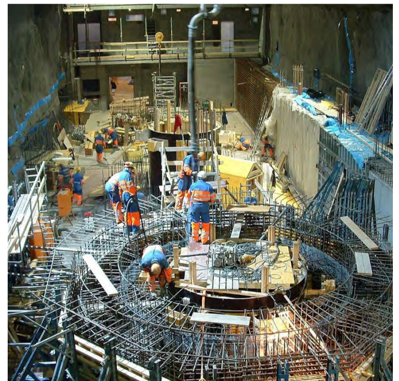
Fljótsdalsstöð kemur vel út í nýju sjálfbærnimati sem nú er opið til umsagnar. Myndin er úr hverflasal stöðvarinnar í Valbjófsstaðarfjalli þegar stöðin var í byggingu. Fljótsdalsstöð var vígð síðla árs 2007. Mynd / sá
