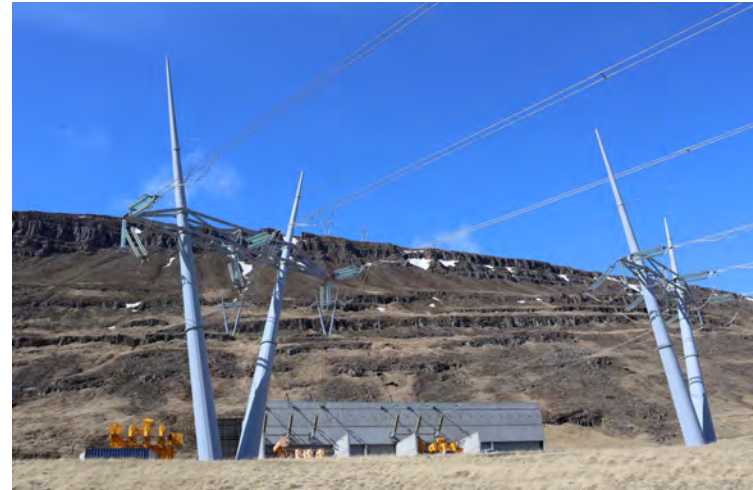
Fljótaldalsstöð í Fljótaldal. Lagt er til í nýrri skýrslu um raforkumál að endurmetin aðgerðaáætlun um orkuskipti verði samþætt innlendra aðgerðaáætlun í loftslagsmálum.
